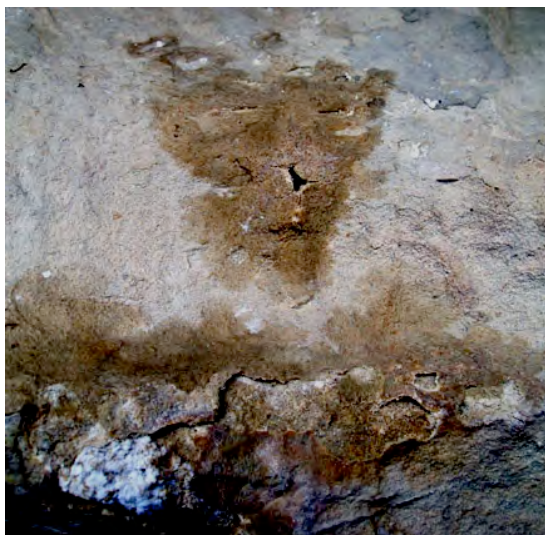
Photo 22: Cloque éclatée située dans une zone visiblement plus humide.
