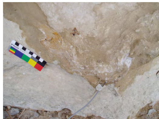
Photo 45: Sonde thermique °C 4 de la station "climat 2". La sonde est collée
