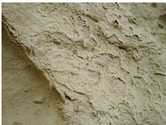
Photo 24: zone présentant une importante accumulation de poussière qui forme des cloques et se desquame
