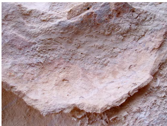
Photo 66: Zone montrant une épaisse couche de poussière avec des tracés digitaux.
