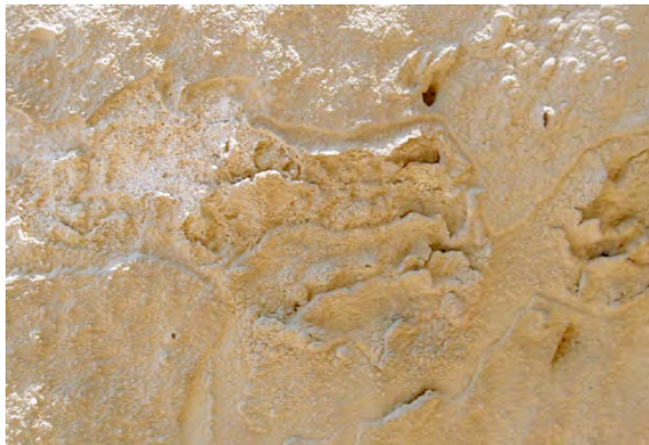
Photo 64: Zone très poussiéreuse et peu stable. La couche de poussière s'exfolie sur plusieurs niveaux.
