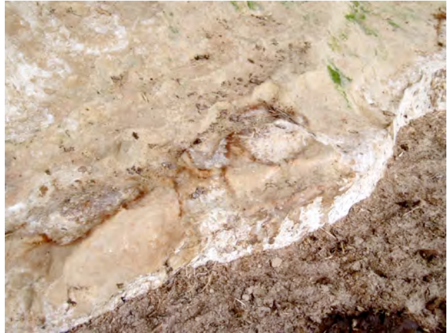
Photo 9: Présence de lignes brunes et de sels dans la roche à proximité du fumier, dans l'alcôve.
