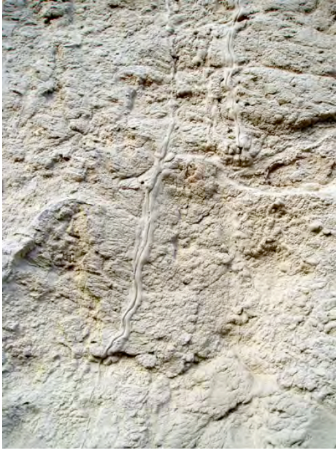
Figure 72: trace du passage de filets d'eau dans de la poussière.
