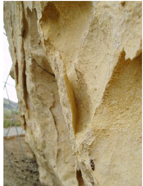
Photo 19: Détail du profil de la paroi montrant d'importantes zones d'érosion qui coupent la surface par dessous.
