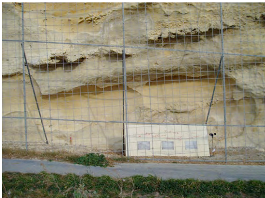
Photo 8, été 2005: zone du site où d'importants motifs peints ont été prélevés en 1916. Il ne reste que des cavités très érodées.
