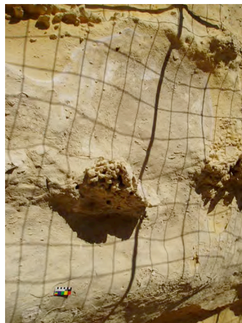
Photo 25: partie de la paroi présentant une auréole plus humide où s'accumule la poussière.
