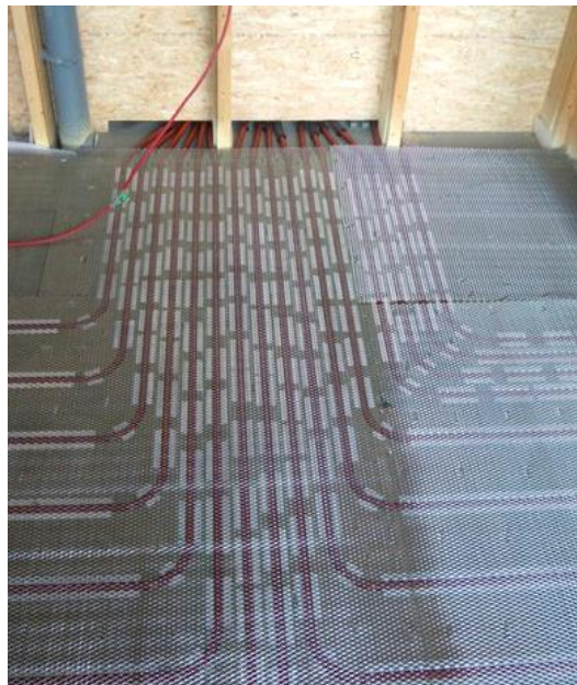
Tuyaux en sortie du collecteur. Le diffuseur en aluminium est régulièrement interrompu pour éviter la surchauffe de la zone. Source : OPAL SYSTEMS
