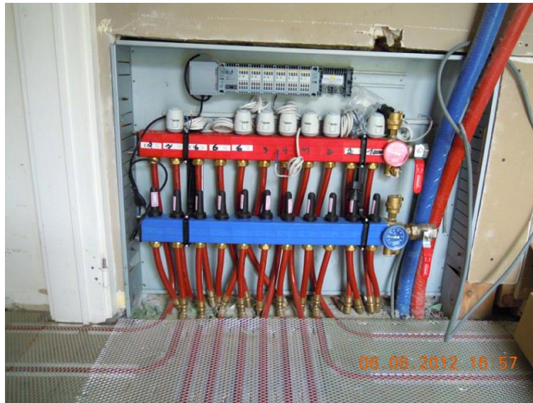
Un collecteur et les différentes boucles qui y sont connectées. Source : OPAL SYSTEMS
