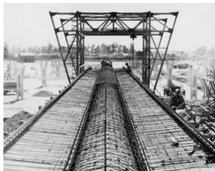
Fabbrica Olivetti Argentina, Buenos Aires 1954-1961, operai al lavoro per la costruzione di una delle travi cave (AdM, Fondo Marco Zanuso, MZ A FOT S 31).
