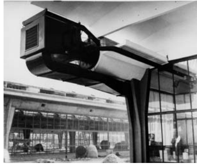
Fabbrica Olivetti, Argentina, Buenos Aires 1954-1961. Trave cava in costruzione e testata con condizionatore a cantiere quasi ultimato (AdM, Fondo Marco Zanuso , MZ A FOT S 31).
