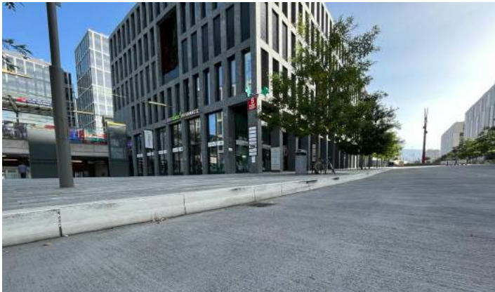
Initialement prévu pour un arrêt de bus, ce trottoir très haut n'a pas été modifié malgré l'abandon du projet
